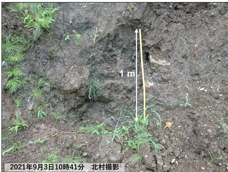
図 3 試料採取地点 B1 の未崩落の盛土の写真. すべて黒色の土砂からなる盛土.
